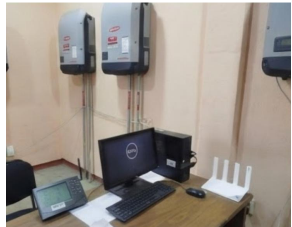
Figura 6. Equipo de cómputo funcionando como Gateway, con intervención en el borde, en la caseta de inversores de la UNISTMO Campus Tehuantepec. Fuente. Fotografía tomada por el autor.
