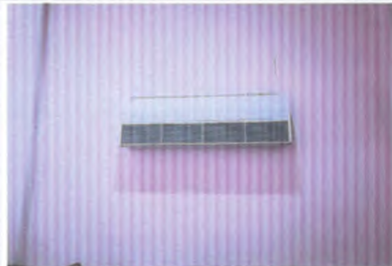
EVAPORADOR EN SALA DE ESPECTADORES
