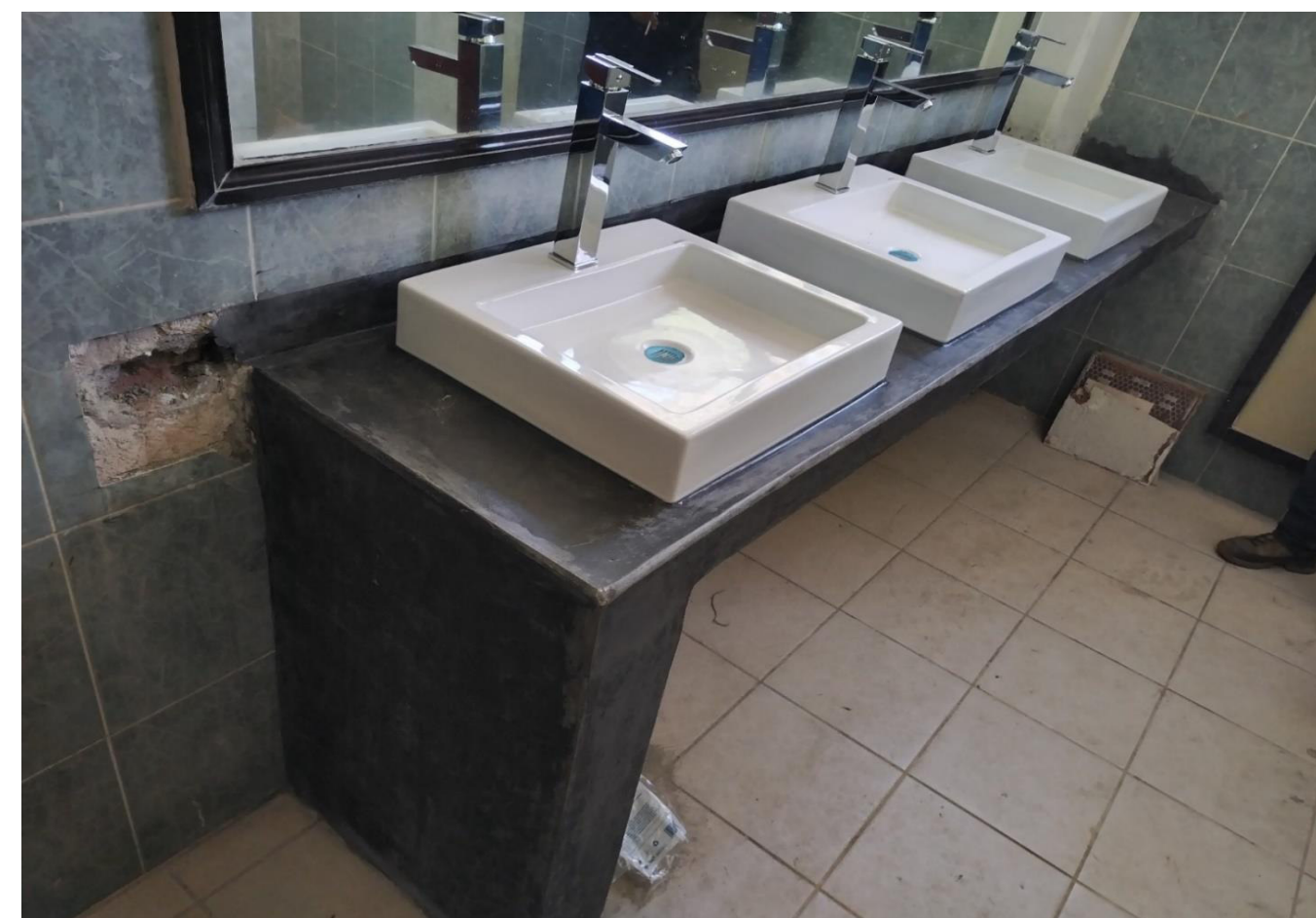
Construcción de meseta y suministro y colocación de lavabos en baños de biblioteca en Campus Tehuantepec.
